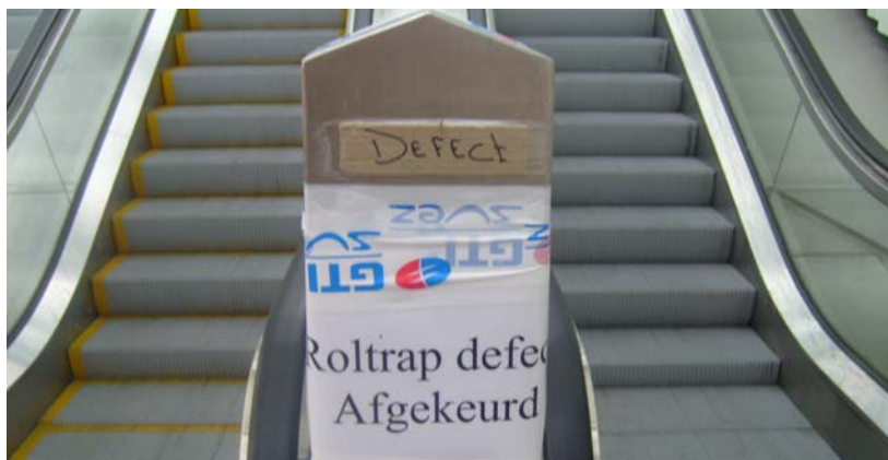
Defecte roltrappen in de Tweede Heinoordtunnel (afb.15)
